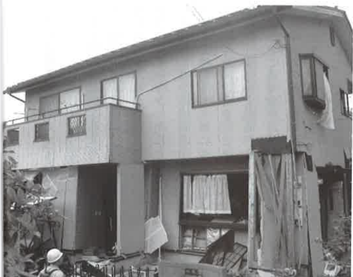
設計の配慮不足により大きな建物被害を招いたケースも見られた 写真提供:五十田博教授
